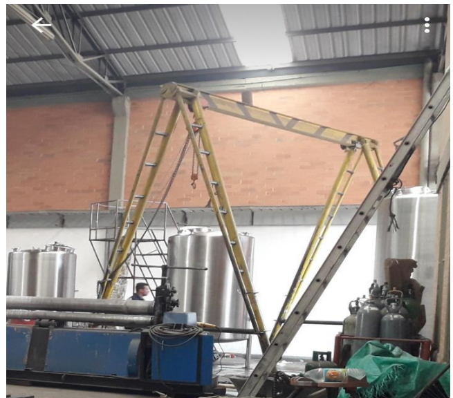
Figura 2. Puente grúa de la planta de producción.
