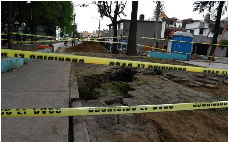
Figura 5. Falla geológica Quinta Cerrada avenida 503, Colonia San Juan de Aragón 1ra Sección Fuente: Mendoza, 2021.
