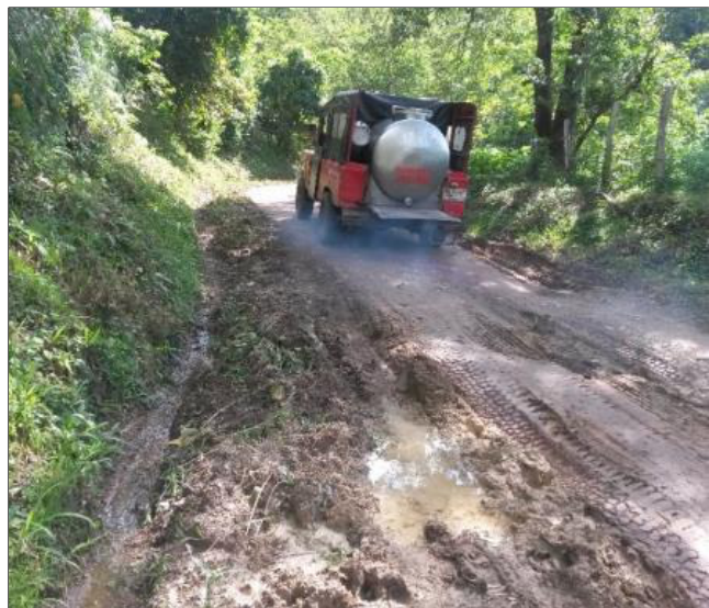
Figura 11. Deterioro de vías afecta el transporte
