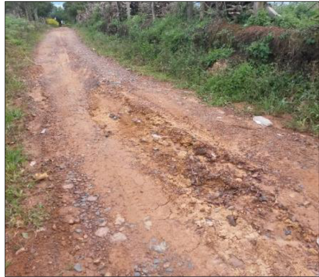
Figura 10. Cárcava en vía sin cunetas
