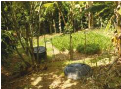
Figura 1. Sistema modular de tratamiento anaerobio (SMTA) Finca La Fortuna.
