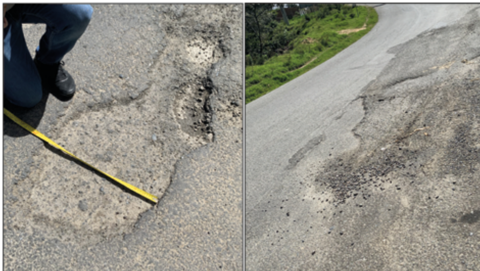
Figura 2. Ejemplos de deterioro detectados en el área de estudio
